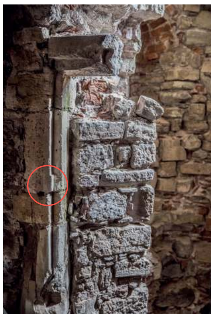
20. att. Ieejas durvis torņa trešajā stāvā. Akmeņu aploda veidota no sekundāri izmantotiem elementiem. Ar apli iezīmētais izvērējums daļēji nokalts, lai gropē ievērtu vērti G. Indrēvica foto, 2017
