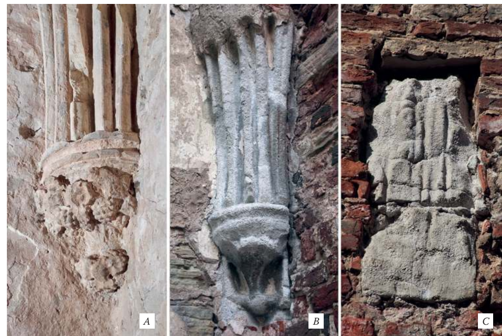
13. att. Mākslīgā akmens konsoles Cēsu pili A – "mestra istaba"; B – dienvidu remtera ZA stūrī; C – dienvidu remtera Z sienas vidusdaļā K. Hermaņa foto, 2021
