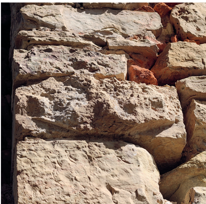
11. att. Lielā remtera loga nolauztā horizontālā šķērša vieta ar daļēji saglabājušos profilu Autora foto, 2022
